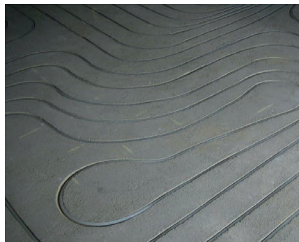
De freesmachine freest te sleuven in de bestaande chape, hierin komen de leidingen. Foto van Vasco
