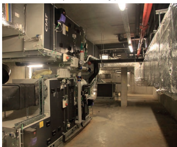
De technische ruimtes zijn onopvallend ingeplant
