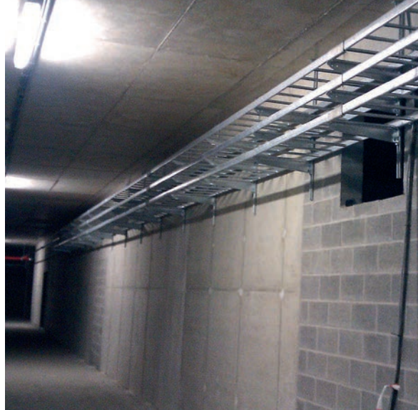
Draadgoten en kabelladders in het 'Hôpital Civil Marie Curie' in Lodelinsart (Beeld: Vergokan)
