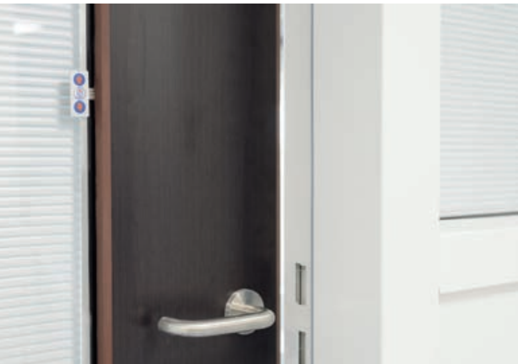
ZH Maas en Kempen Maaseik I RF30 draaideur met PU kantlatten en glaslatten, zijlicht (beglazing met lamellen, elektrisch bediend)
